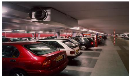
Ondergronds parkeren (bron: Novenco B.V)
